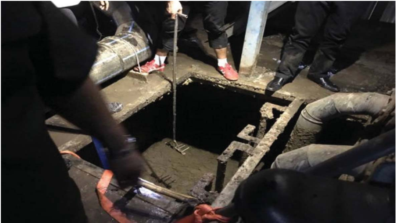
รูปที่ 4 ฝาบ่อพักน้ำเสียโรงงาน CPF ที่ถูกเปิดทิ้งไว้
