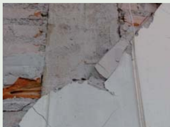
รูปที่ 12 การวิบัติแบบเฉือนของเสาเนื่องจากการถ่ายแรงจากผนังอิฐก่อของอาคารพาณิชย์ 3 ชั้น
