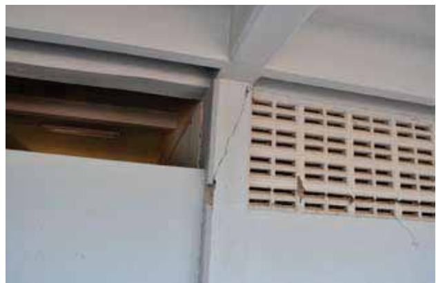
รูปที่ 13 แสดงการวิบัติแบบเฉือนของเสาสั้นในอาคารพักอาศัย 4 ชั้นของตำบลเกาะแม่สาย
