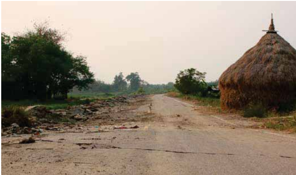
รูปที่ 22 การวิบัติของถนน
