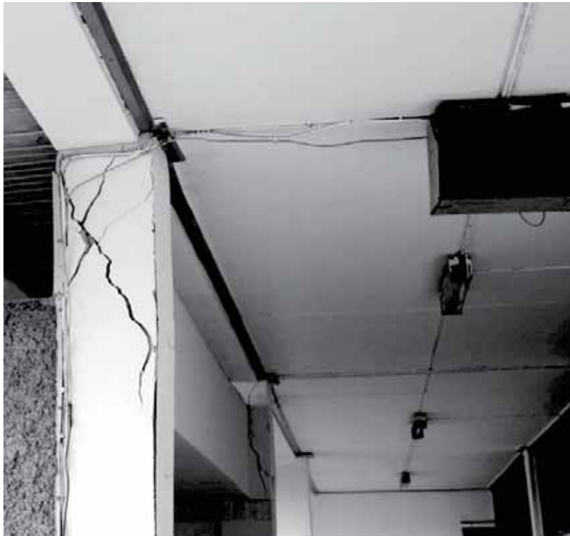
รูปที่ 14 การวิบัติแบบเฉือนของเสาต้นของอาคาร 2 ชั้นของโรงเรียนเม้งรายมหาวิทยาลัยราชภัฏ อ.เมือง จ.เชียงราย เนื่องจากแผ่นดินไหวขนาด 6.3 ในวันที่ 16 พฤษภาคม 2550
