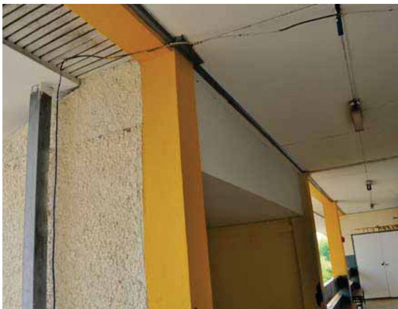
รูปที่ 15 สภาพภายหลังแผ่นดินไหวครั้งนี้ของเสาอาคาร 2 ชั้นของโรงเรียนเม้งรายมหาวิทยาลัยราชภัฏ ที่ได้รับการปรับปรุงแล้ว
