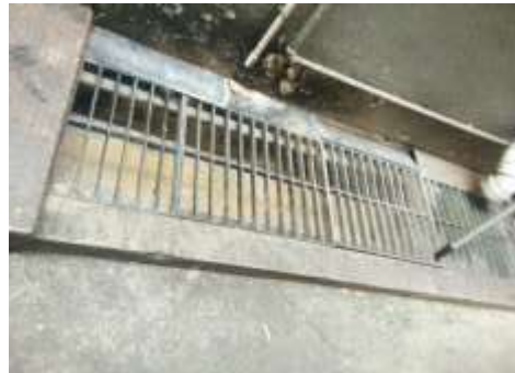
ภาพที่ 6 ท่อระบายน้ำหน้าครัวประกอบอาหาร
