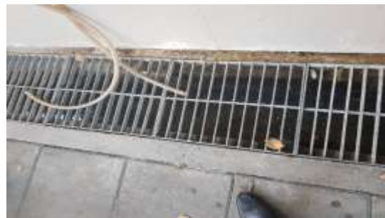
ภาพที่ 15 ท่อระบายน้ำด้านหลังครัวเตรียมอาหาร
