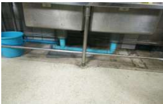
ภาพที่ 5 ท่อระบายน้ำจากอ่างล้างอุปกรณ์
